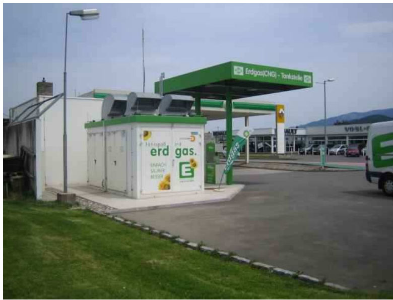
Erdgastankstelle mit Einhausung des Kompressors und des Hochdruckspeichers (HD Speicher)
