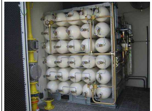
Erdgashochdruckspeicher (HD Speicher)
